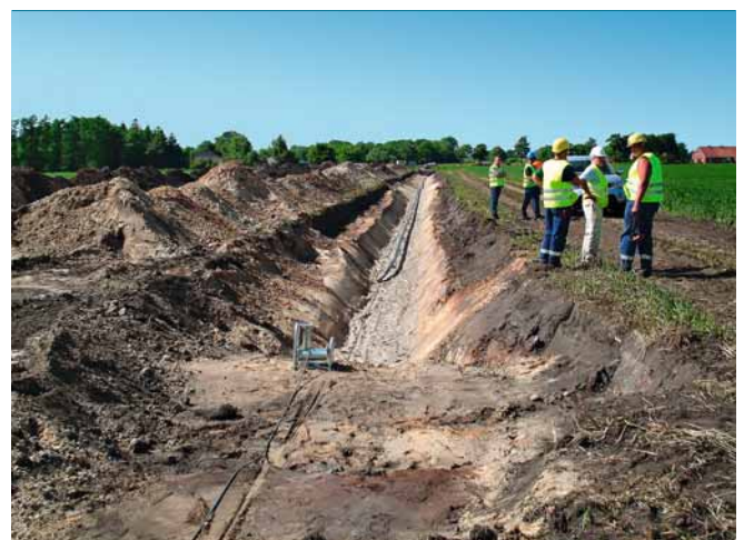
4 Verlegung der ersten Kabelstücke (Betriebsspannung 150 kV, Übertragungsleistung 400 MW) im Landkreis Aurich im Juni 2008
